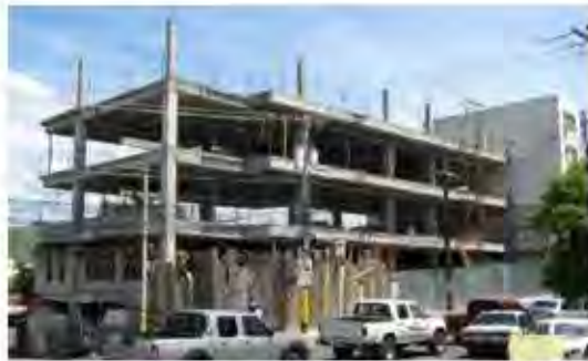
Edificio abandonado en Tegucigalpa.
